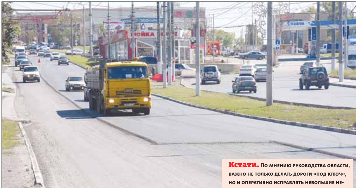
На Ложевой ремонт в разгаре, машины едут и по старому, и по новому асфальту.
